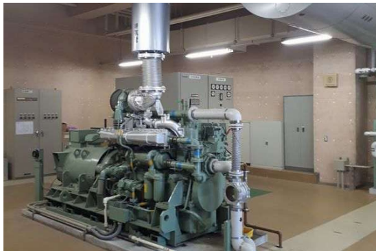
非常用自家発電設備
