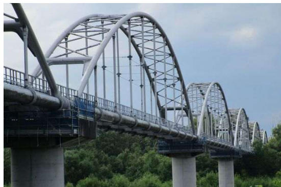
札内川水管橋
